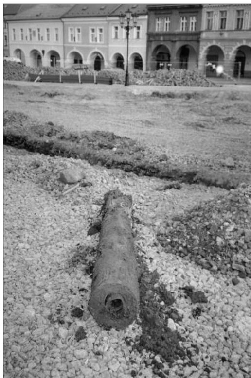
Obr. 4. Jičín, Valdštejnovo náměstí 2009. Vodovod do rezidenční části zámku
