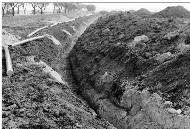
Obr. 4. Radim, „Na Černé“, rýha vodovodu, objekt 7. Celkový pohled na příkop od SZ. Vpředu vnitřní okraj příkopu s částí profilu V1–Z1 (foto M. Vávra)
