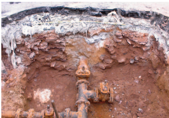
Obr. 6. Český Brod, křižovatka ulic před Kouřimskou branou, výkop pro vodovod. Zeď zjištěná v severní stěně výkopu. Pravděpodobně pilíř mostu přes městský příkop. Pohled od jihu. Foto M. Křemen.
