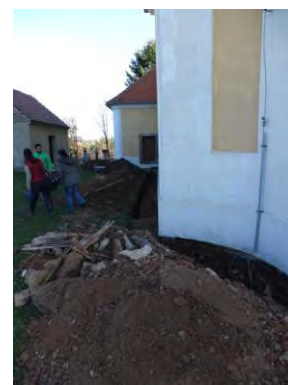
Všesulov – výkop kolem kostela (obr. 5) – posouzení míry narušení hrobů a pokyny k naložení s nalezenými kostmi.
